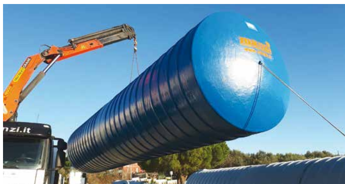
2. Il serbatoio per sversamenti accidentali
