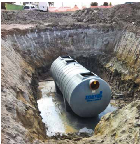
3. Il disoleatore a coalescenza installato presso Cantiere ANAS sulla S.S. 729 "Sassari-Olbia"
