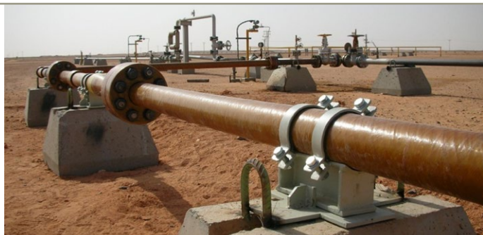
2. Tubazione in vetroresina per trasporto idrocarburi
