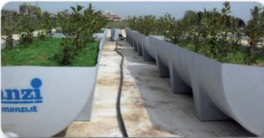
Evapotraspirazione fuori terra - punto vendita carburanti Q8 Roma Aboveground evapotranspiration plant - Kuwait service station in Rome
