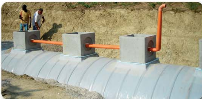
Impianto per Comune in provincia di Pescara, 200AE Sewage purification plant for a municipality near Pescara (center Italy), 200PE
